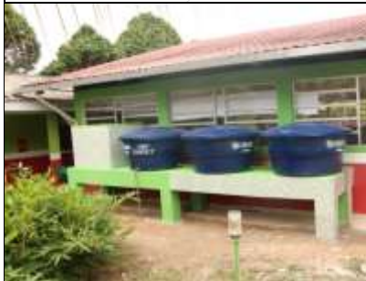
Figura 27 - Sistema de redistribuição da água pluvial armazenada
