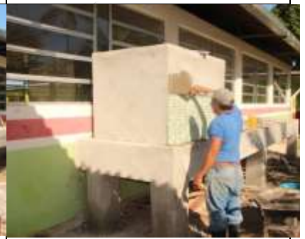
Figura 9 - Revestimento cerâmico com argamassa
