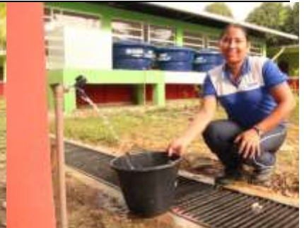
Figura 32 - Projeto PIBIC promove o aproveitamento sustentável da água pluvial no IFAM, o sistema oferece fornecimento contínuo e estável, além da preservação ambiental no controle erosivo
