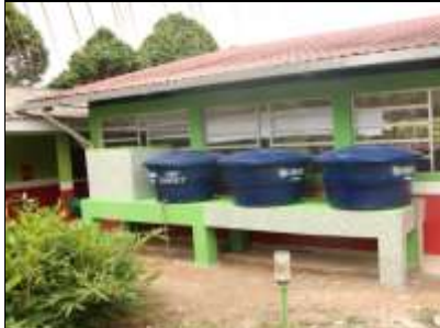
Figura 33 - Sistema de redistribuição da água pluvial armazenada
