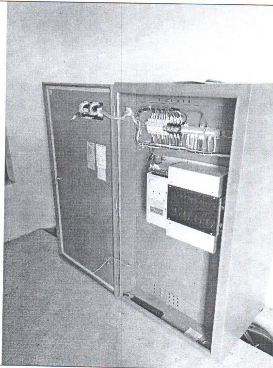
Legenda: Quadro de transferência automática (QTA) – porta aberta
