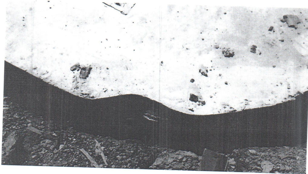
Fotografia 7 – Falha na concretagem da tampa do sumidouro
