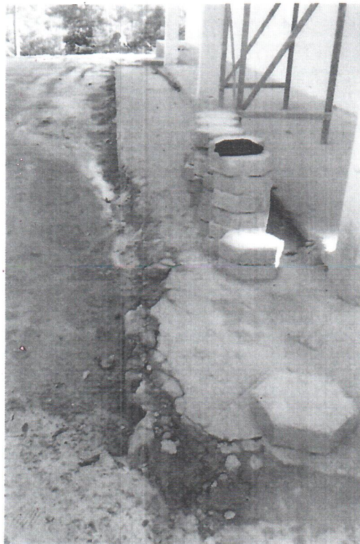
Fotografia 3 – Calçada danificada por máquinas em operação de movimento de terra.
