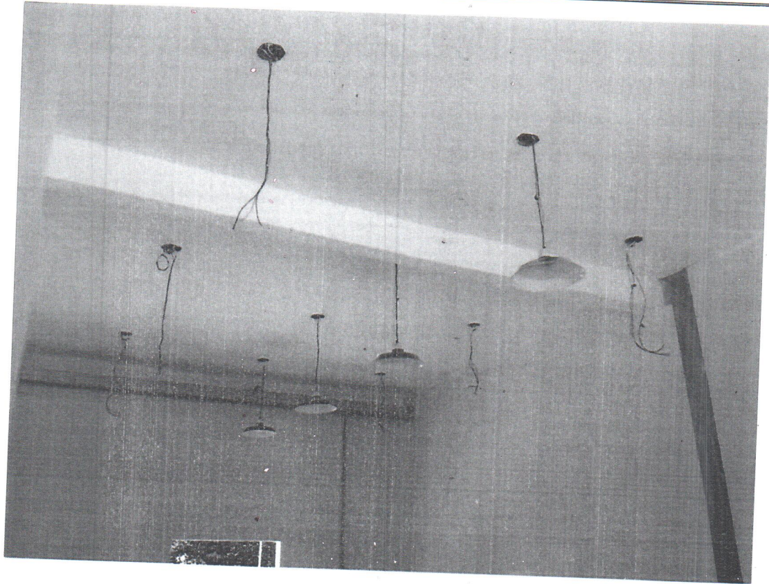
Fotografia 12- Luminárias suspensas sem tirantes.
