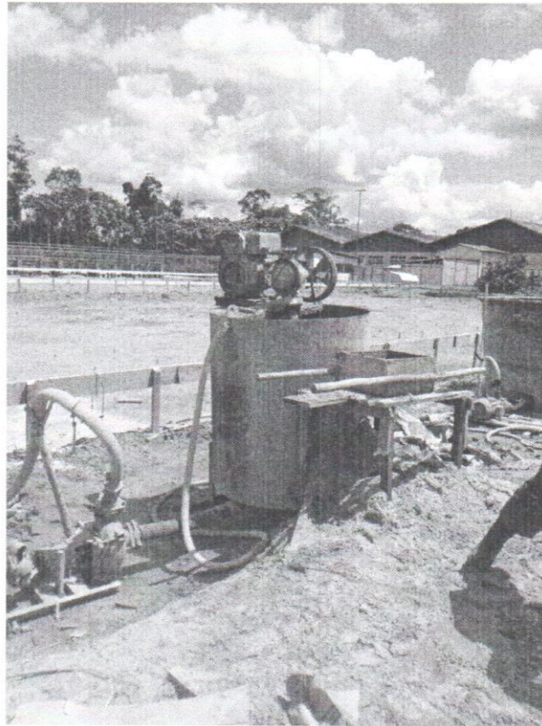
BOMBA HIDRÁULICA DE PRESSÃO E TANQUE DE ARGAMASSA
