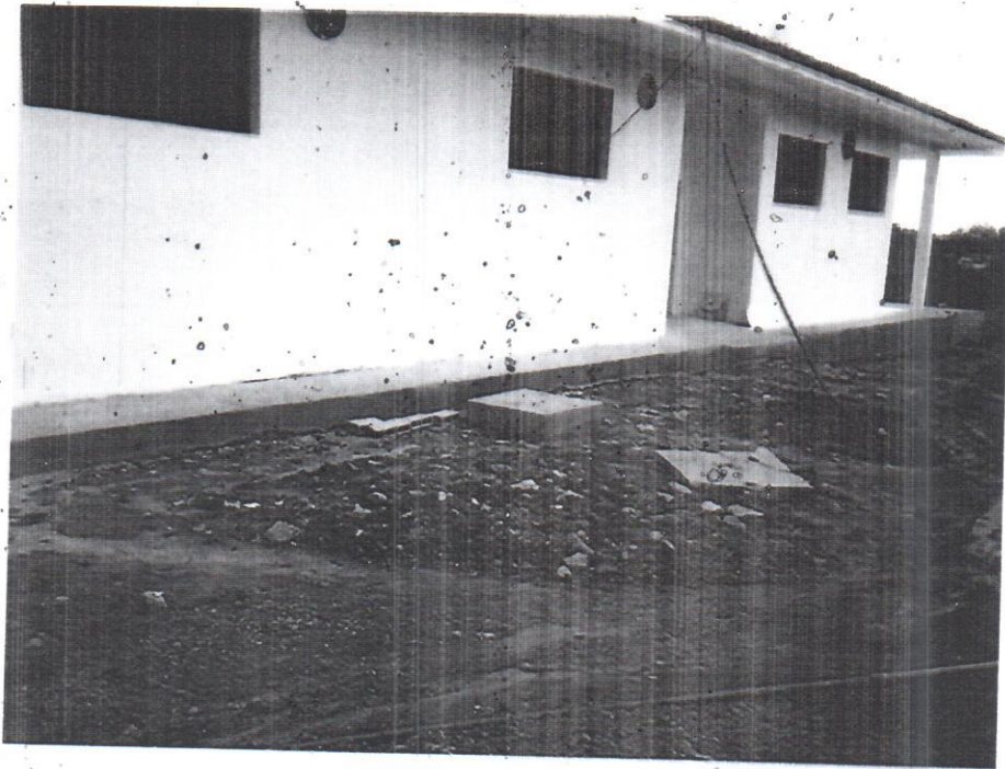
Fotografia 3 – Lateral Direita - Ausência das Esquadrias (ausência de peitoril em granito) e da Instalação do Exaustor (Foi realizada apenas a colocação)
