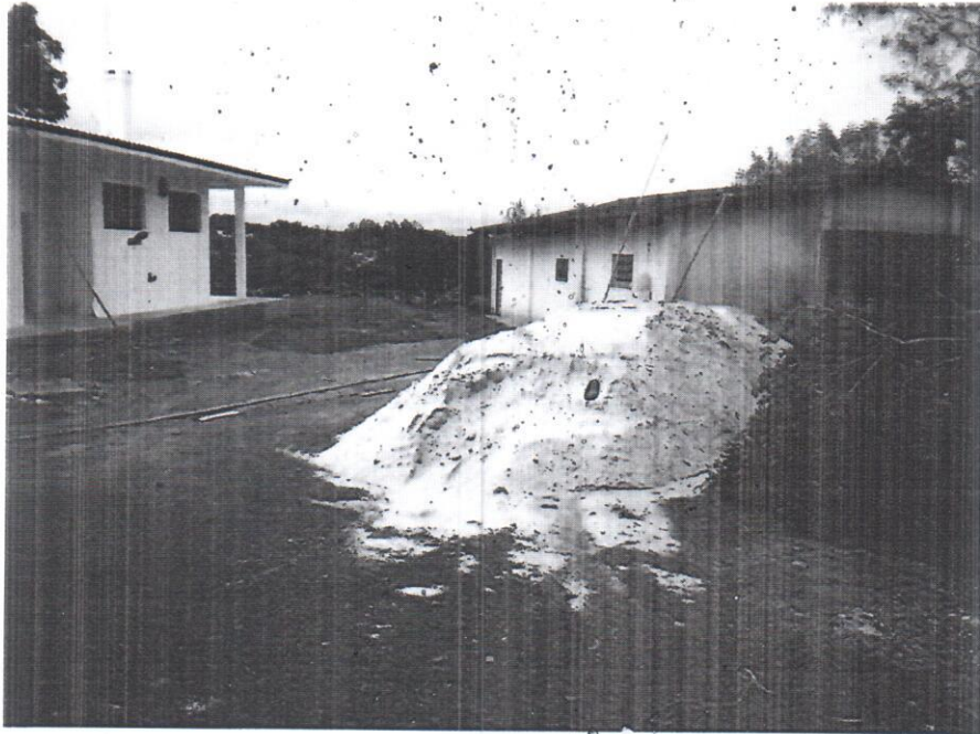
Fotografia 1 – Vista externa da Edificação e Estacionamento (Ausência da colocação dos blocos sextavados no estacionamento).
