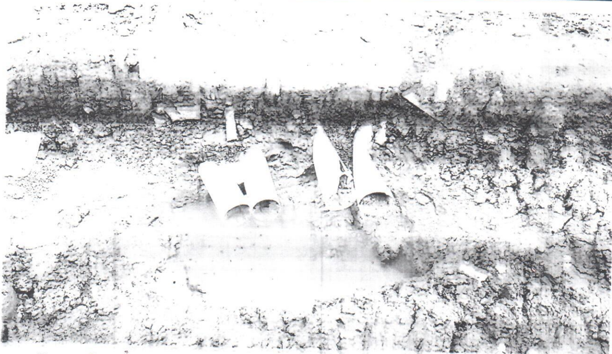
Fotografia 8 – Vista Instalações de Hidro sanitárias (Ausência de Caixa de Inspeção).
