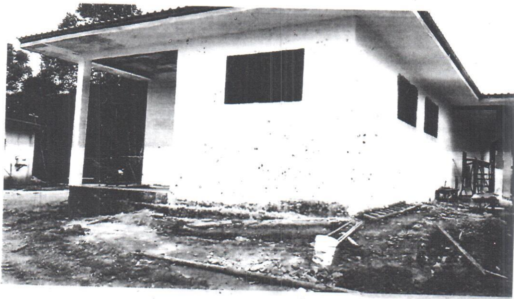
Fotografia13- Vista Lateral Direita (Ausência de calçada e Pavimentação com Bloco Sextavado)
