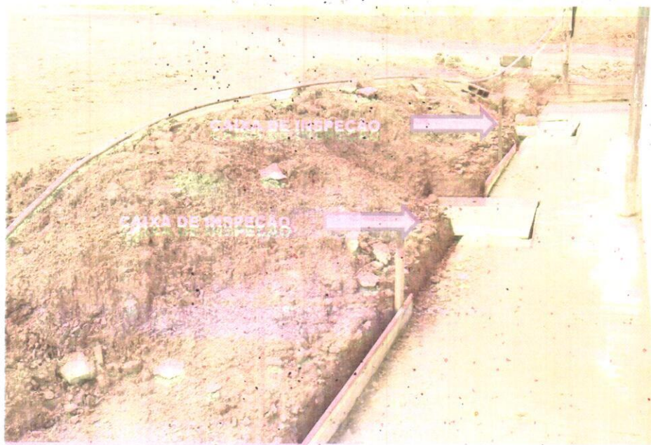
Fotografia 2 – Caixas de Inspeção do Sistema Hidro sanitário
