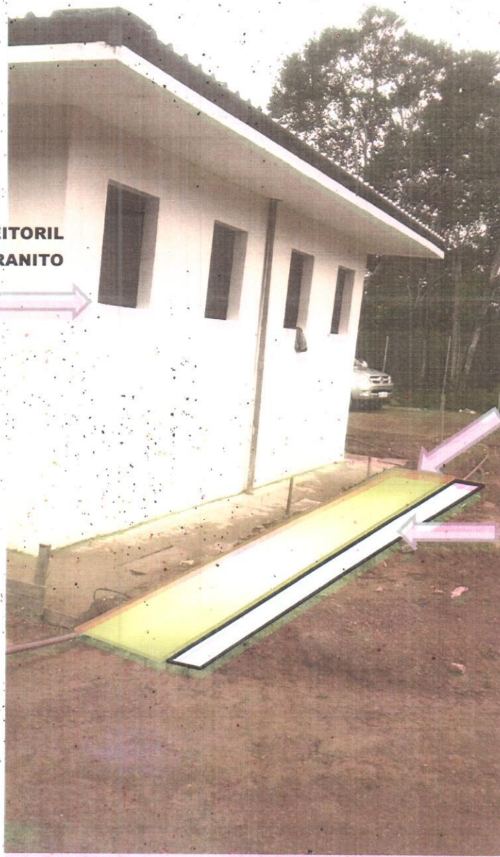
Fotografia 3 – Esquadrias (ausência de peitoril em granito)/ Local para execução de canaleta para drenagem e área ajardinada.
