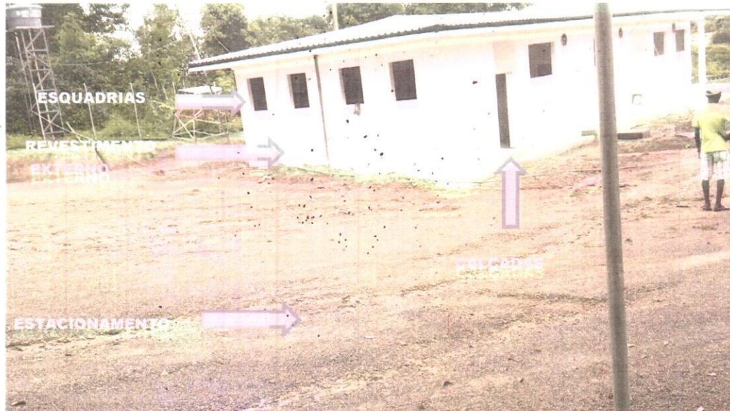
Fotografia 1 – Vista externa da edificação e Estacionamento (Calçada ao redor do prédio, Emassamento externo, ausência de todas as esquadrias, ausência da colocação dos blocos sextavados no estacionamento).
