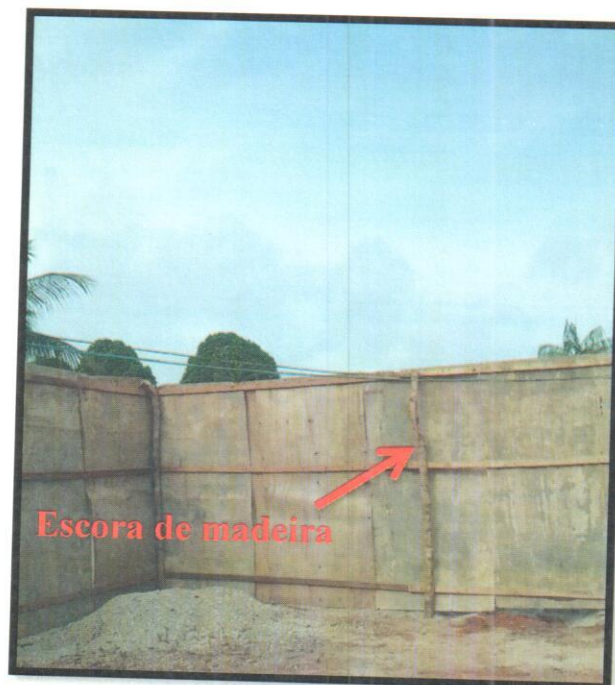
Fotografia 6 – Tapume empinado e fora da especificação do SINAPI.
