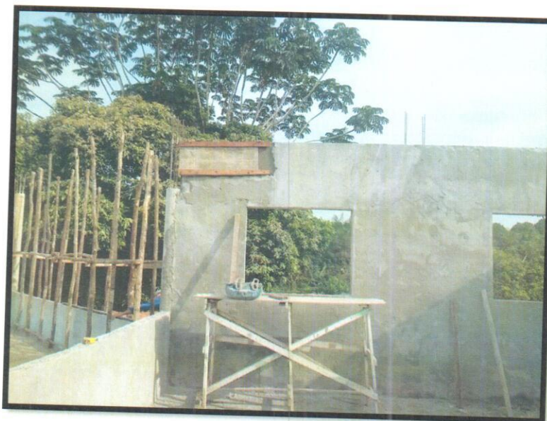
Fotografia 3 – Forma da viga ligeiramente desnivelada.
