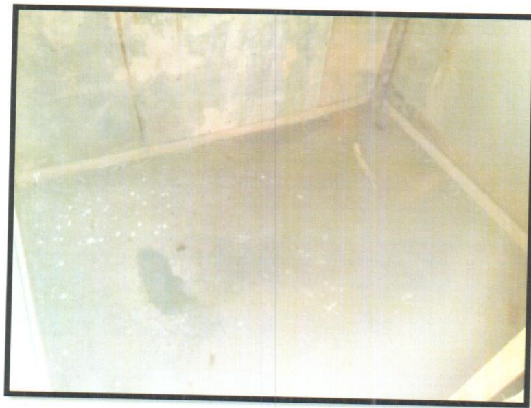
Fotografia 5 – Compartimento do barracão onde deveriam ser implantadas as instalações sanitárias.
