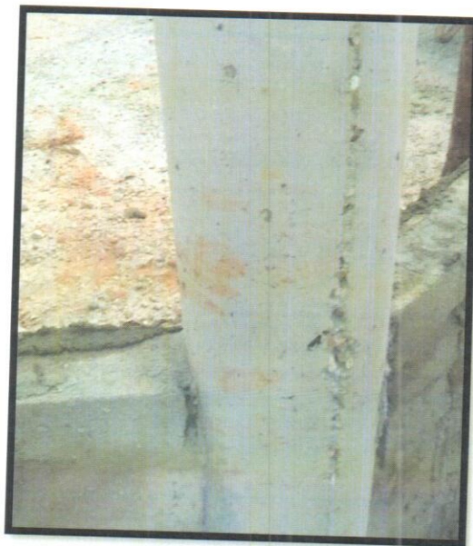
Fotografia 7 – Pilar com concreto adensado inadequadamente.
