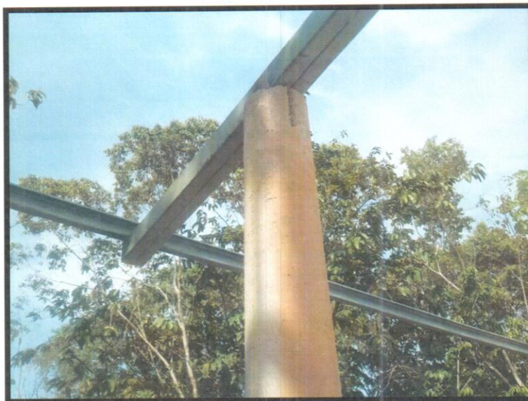
Fotografia 5 – Ferragem do pilar exposta.
