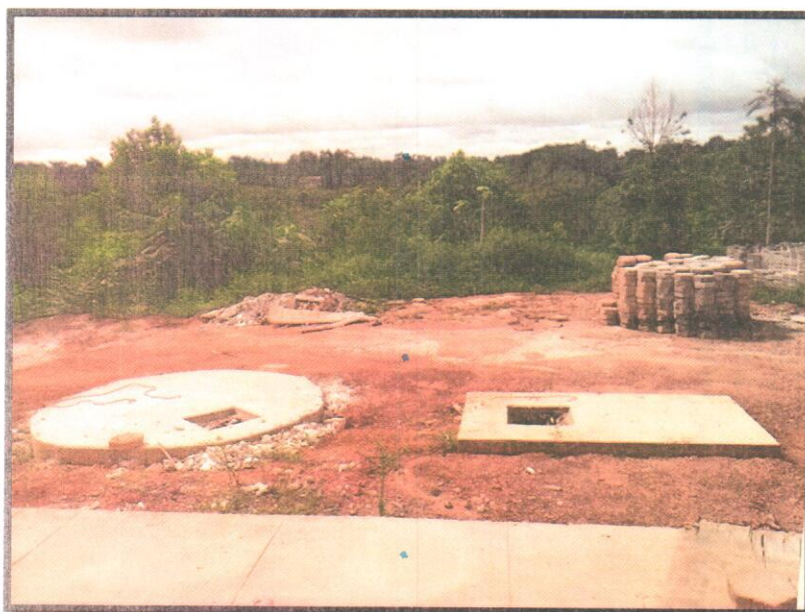
Fotografia 4- Sumidouro, Fossa Séptica (Esquerda para Direita)
