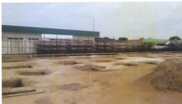
Figura 04: Deterioração das armaduras de aço, que estão ao relento invés de aplicadas às peças de concreto.
