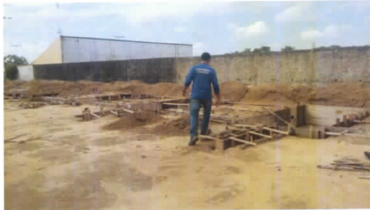
Figura 02: Montagem de formas dos blocos de fundação, sem, no entanto, realizar-se a confecção da peça de concreto (posicionamento da armadura de aço e posterior concretagem), além do baixo quantitativo operacional na obra;
