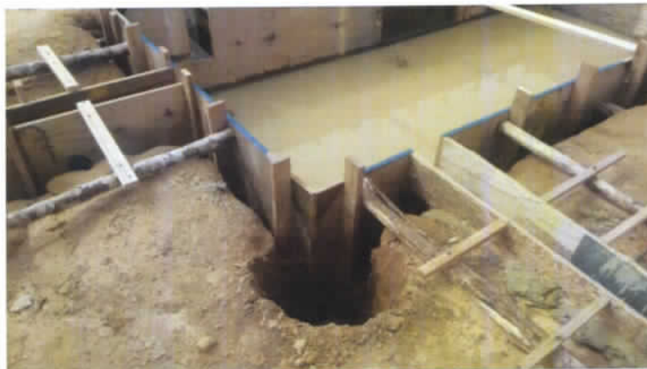
Figura 03: Acúmulo de água no interior das escavações, prejudicando a qualidade das formas;
