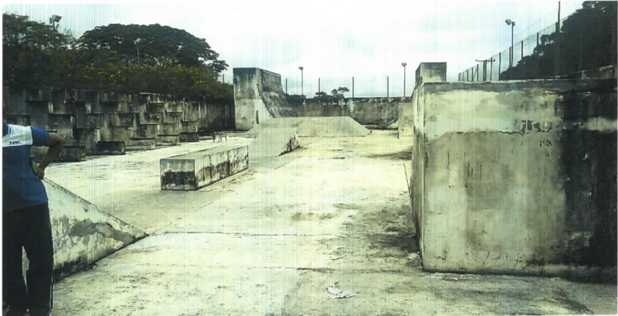
Vista do Piso da pista de Skate com indícios de infiltrações e fissuras ao longo de todo pavimento
