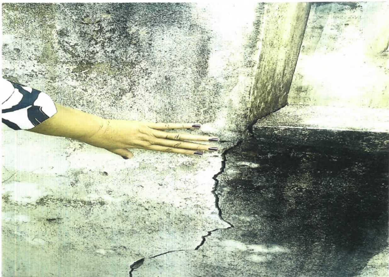
Vista do Elemento Arquitetônico com uma grande trinca, comprometendo sua utilização
