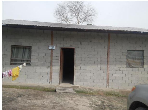
Frente da casa. Obs: local das janelas ainda estão sem as mesmas, utilizam cobertores para fechar.
