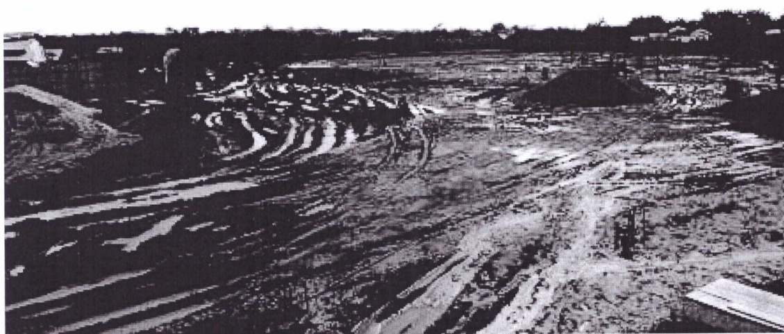
Foto 5. Canteiro de obras da unidade de Eirunepé. Parte das estacas já executadas.
