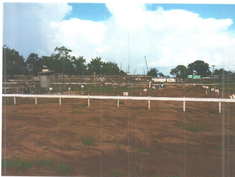
Fotografia 12 – Imagem mostrando em primeiro plano a asa oeste da edificação (apenas a locação da obra) e em segundo plano a parte central e leste da edificação (com execução das vigas baldrame e fôrma dos pilares).
