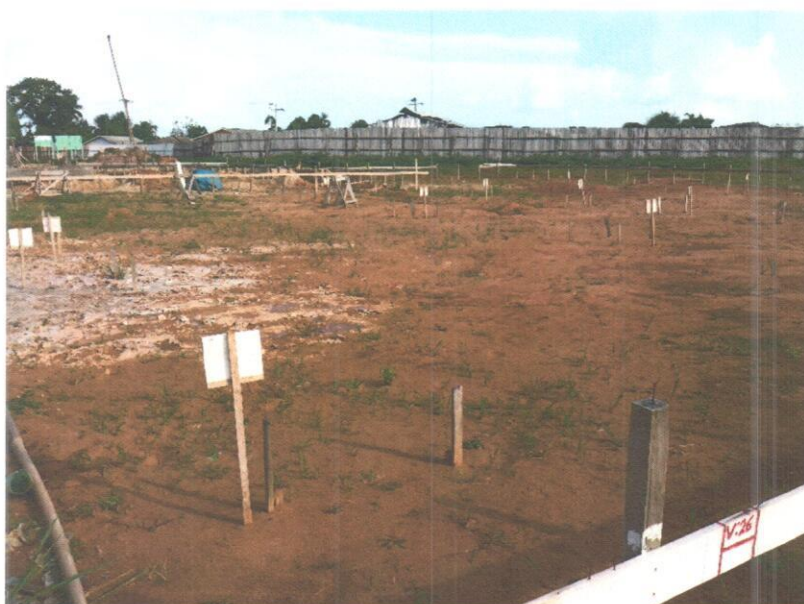
Fotografia 10 – Vista da asa oeste da edificação. Até a presente data não foi executada nenhum bloco de coroamento ou estaca nesta área da edificação.
