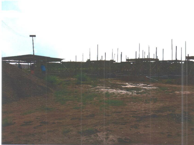
Fotografia 3 – Vista da lateral leste da edificação. Foram executadas as vigas baldrame e está sendo preparada a fôrma dos pilares da asa leste da edificação.
