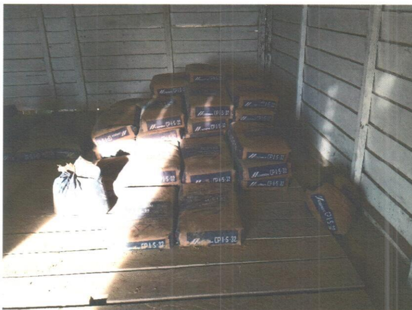
Fotografia 14 – Vista do depósito de cimento da CONTRATADA na obra, cerca de 30 sacos de cimento, o que é um quantitativo insuficiente para o bom andamento dos serviços de infraestrutura do porte da obra em execução.
