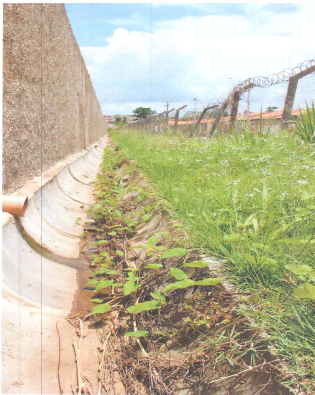
Fotografia-14 – Vista da canaleta do pé do muro de arrimo. Notam-se os drenos em pleno funcionamento e as canaletas obstruídas devido a vegetação rasteira no local.
