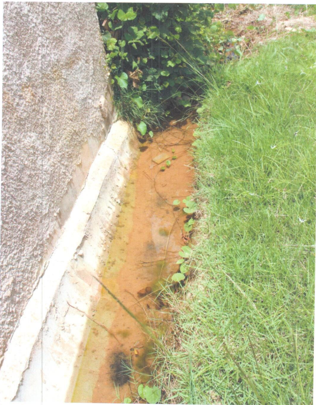
Fotografia-15 – Vista do trecho final da canaleta do pé do muro de arrimo. Nota-se a retenção de água e o acúmulo de sedimentos devido a obstrução da canaleta.
