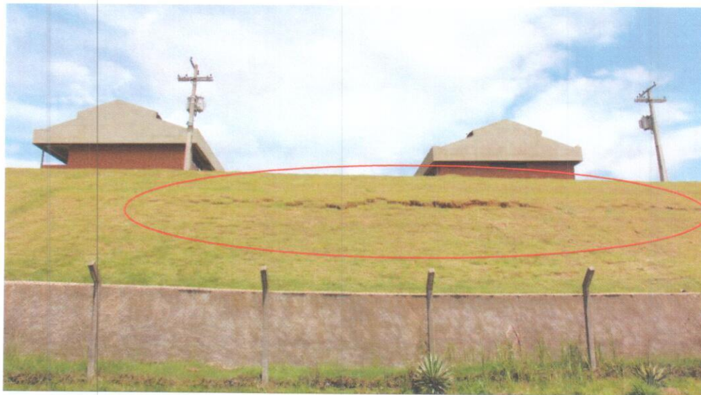
Fotografia-06 – Vista das ravinas no talude entre os Blocos B e C. Nota-se que mesmo com o aparecimento do processo erosivo, não existe nenhum depósito de sedimento no pé do talude.
