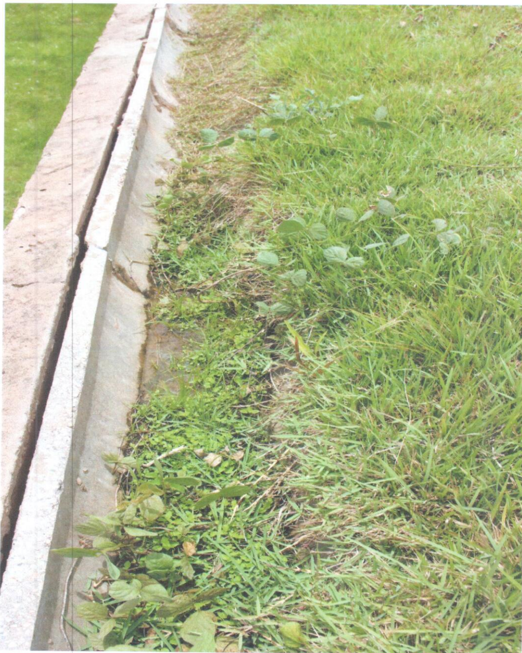
Fotografia-08 – Vista da drenagem superficial no topo do muro de arrimo. Nota-se que devido à obstrução das canaletas pela falta de manutenção, ocorre à retenção da água e consequentemente o desanelamento entre as peças devido seu transbordamento, como também contribuindo com a desestabilidade do pé do talude.
