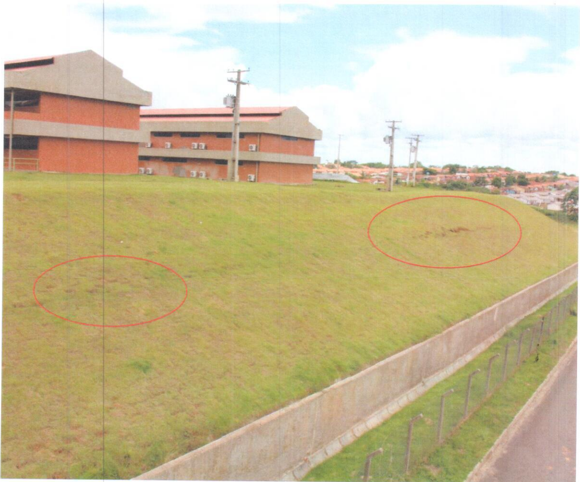
Fotografia-01 – Vista geral do talude. Ao centro e a direita vista das ravinas formadas eventualmente devidas à ação das chuvas e das intempéries, ou até mesmo devido à compactação inadequada da proteção natural do talude entre o Bloco B e C.
