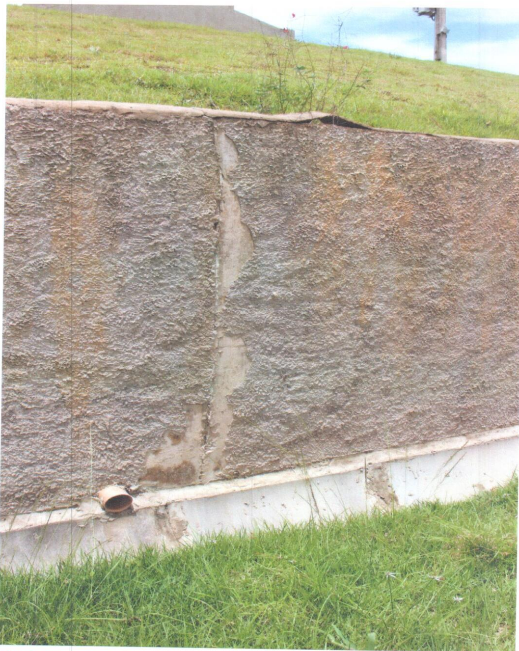
Fotografia-16 – Vista da junta de dilatação vertical no paramento externo do muro de arrimo entre o Bloco B e C. Nota-se a desagregação do reboco ao longo da junta.
