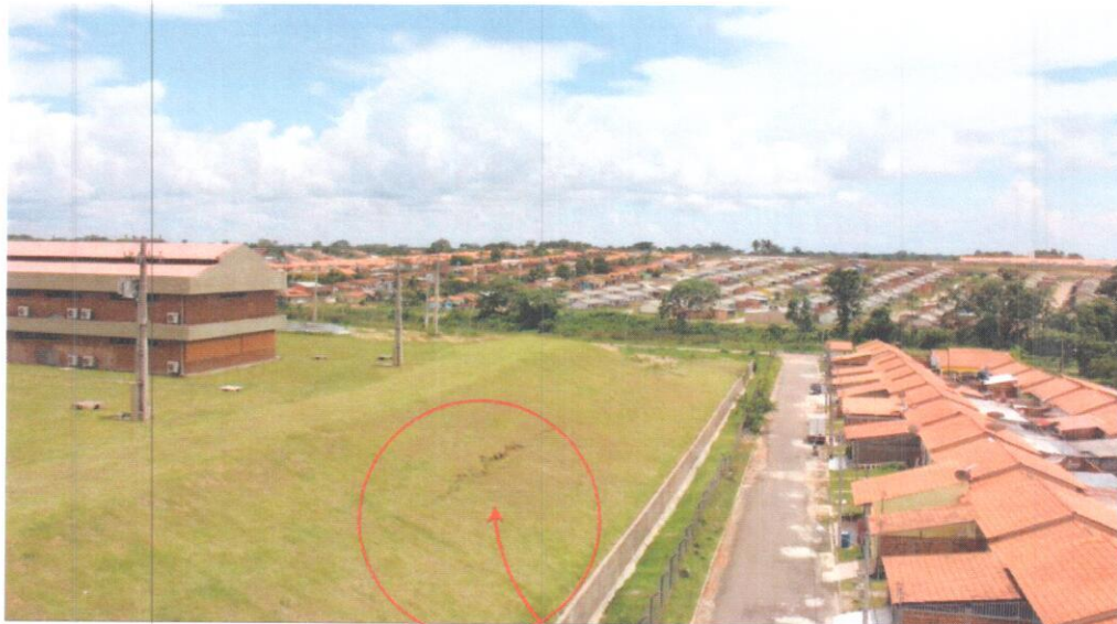
Fotografia-04 – Vista do talude entre os Blocos B e C. No destaque ravinas em processo de crescimento principalmente devidas à ação das chuvas e das intempéries, devido a falta de proteção natural do talude.
