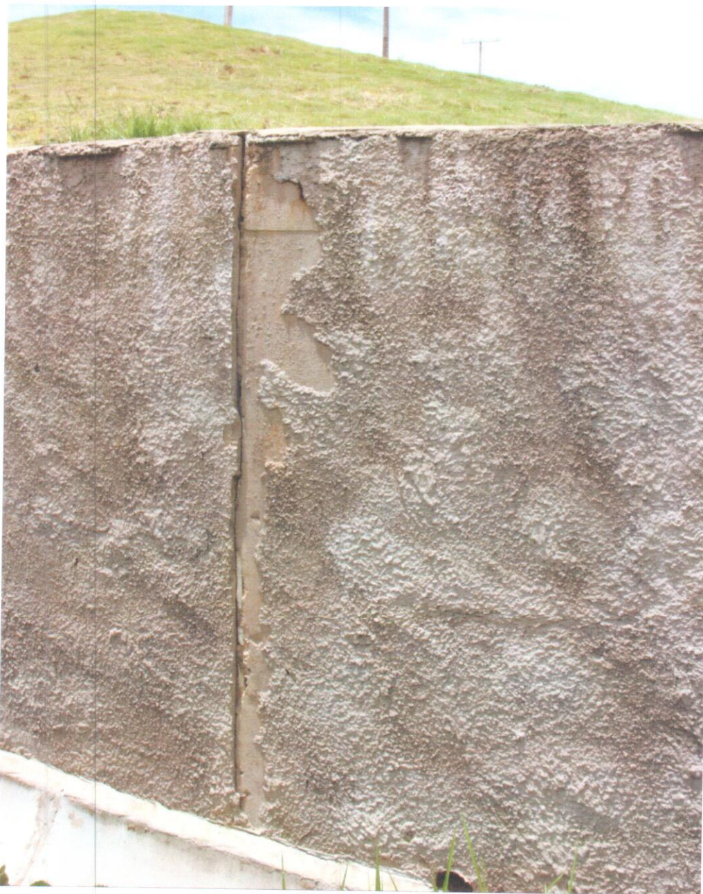
Fotografia-17 – Vista da junta de dilatação vertical no paramento externo do muro de arrimo próximo a saia da ala leste. Nota-se a desagregação do reboco ao longo e a junta em EPS.
