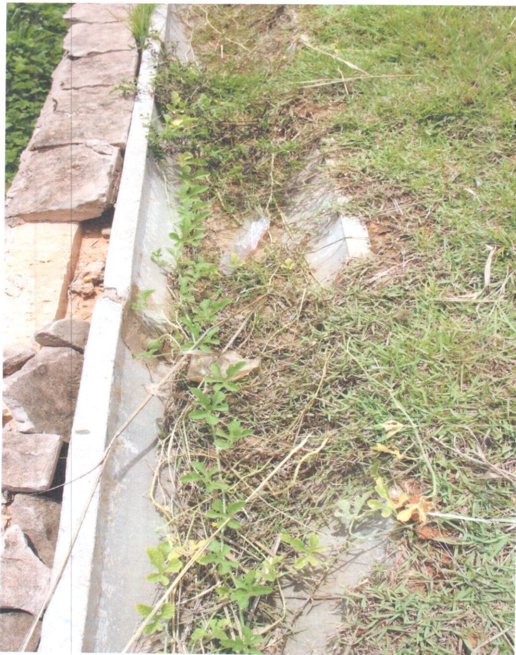
Fotografia-12 – Trecho da canaleta no topo do muro de arrimo bastante deteriorado devido à falta de limpeza das canaletas e a manutenção do talude.
