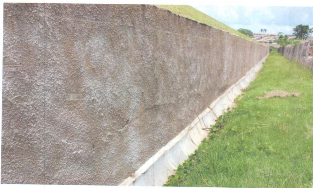
Fotografia-19 – Vista do paramento externo do muro de arrimo no sentido oeste-leste. Nota-se o avanço da vegetação rasteira sobre a canaleta, devido a falta de limpeza.
