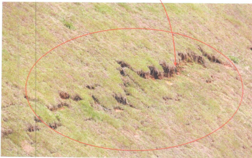
Fotografia-05 – Vista da ravina em estado de crescimento. Devido à falta de proteção natural nesta área afetada, às chuvas carregam terras e sedimentos causando o aumento do processo de erosivo.
