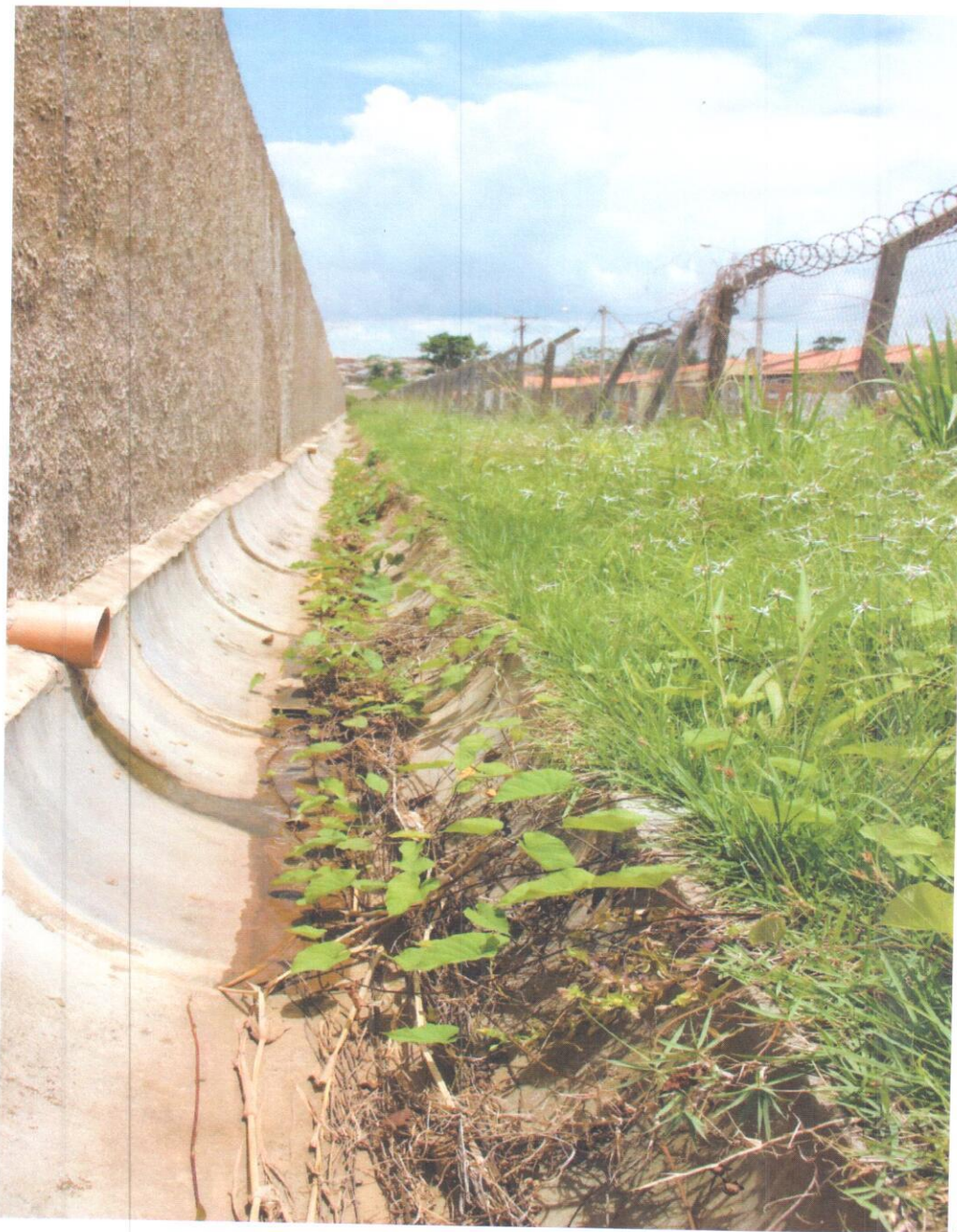
Fotografia-21 – Vista do paramento externo do muro de arrimo no trecho entre o estacionamento e o bloco A. Nota-se a obstrução da canaleta completamente devido o avanço da vegetação rasteira.
