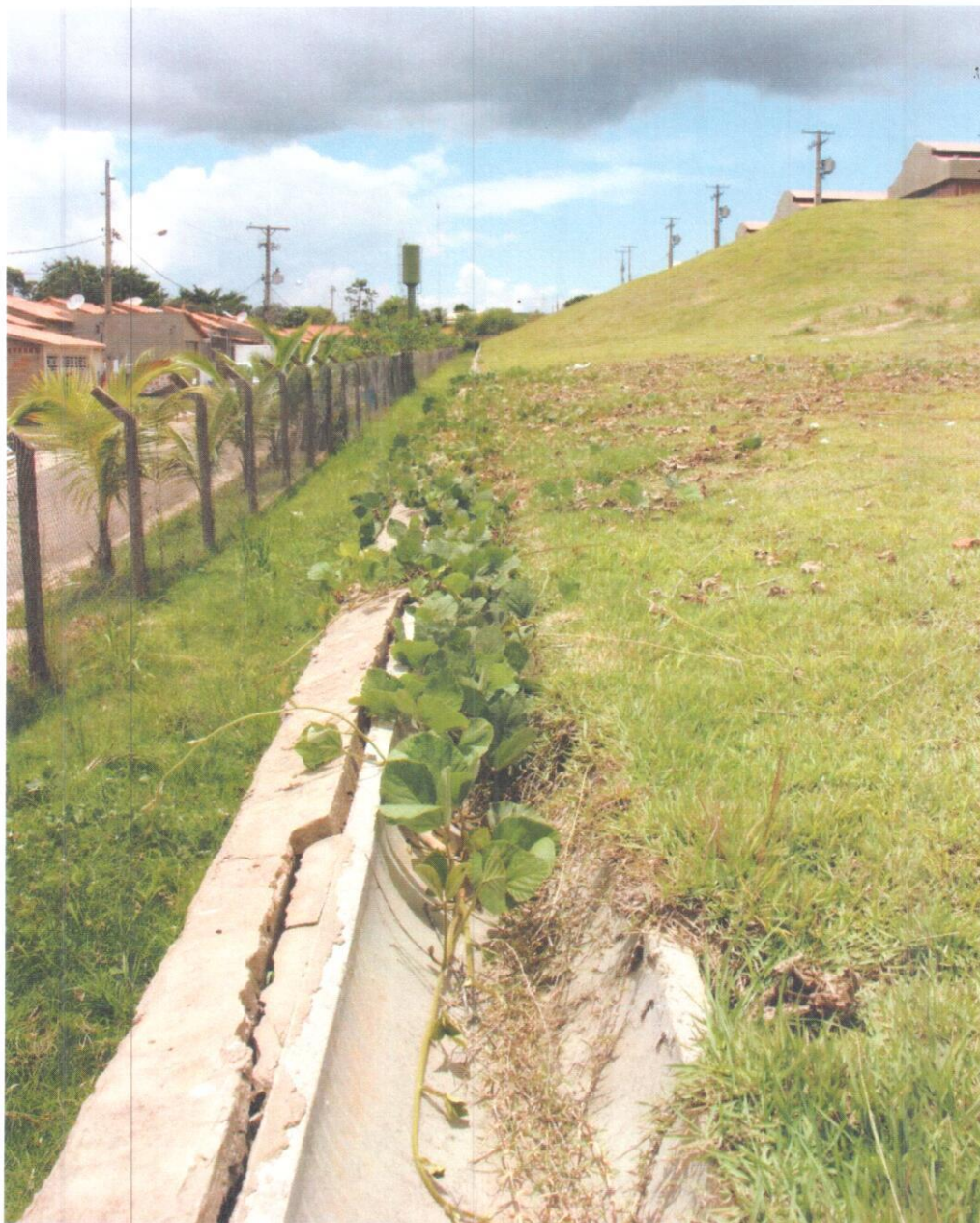
Fotografia-09 – Vista de outro trecho da canaletas obstruídas pela vegetação rasteira que impede o escoamento das águas das chuvas e conseqüentemente provocando o desanelamento das peças e a desolidarização das canaletas com a parte superior do muro.
