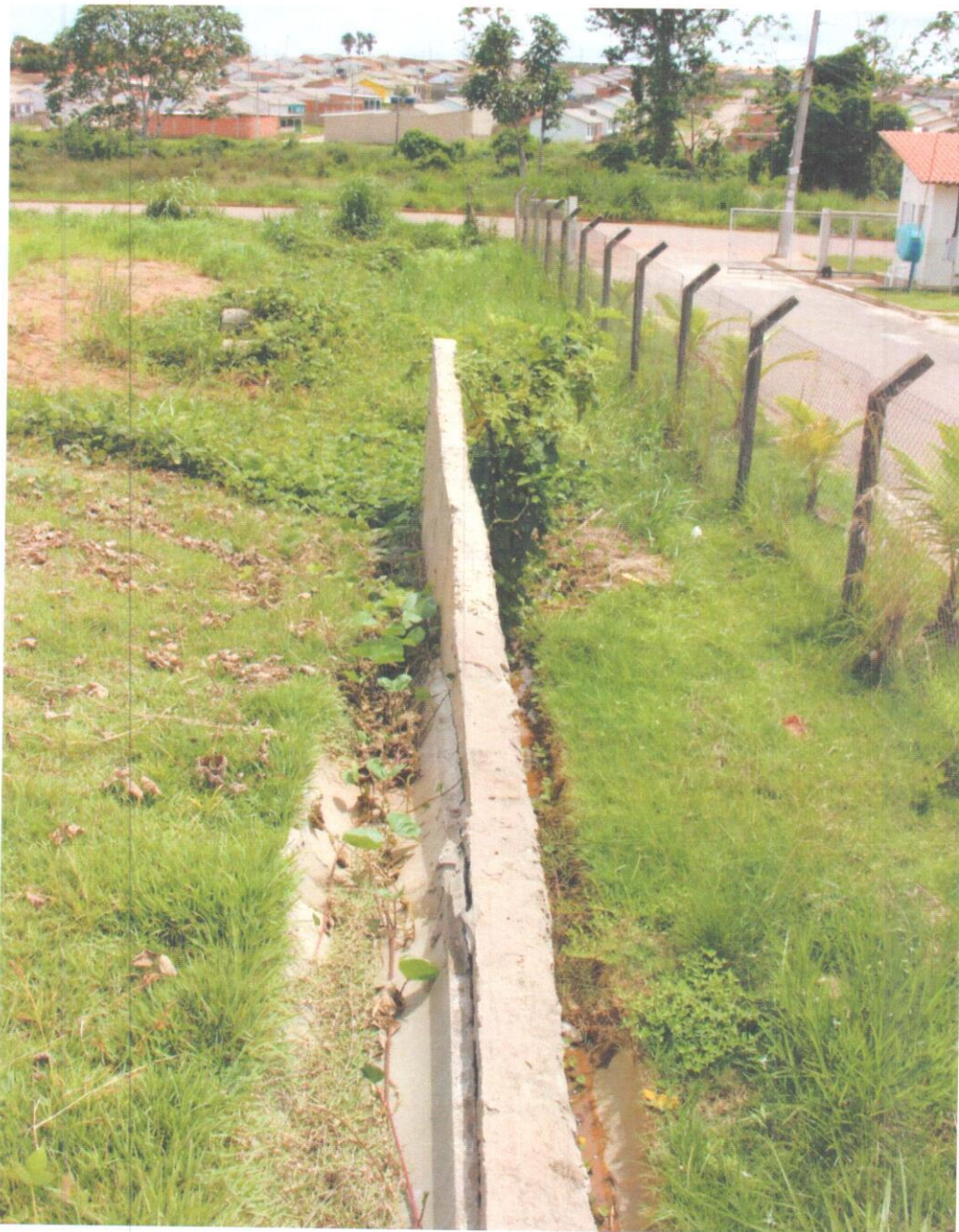
Fotografia-13 – Trecho do final do muro de arrimo apresentando obstrução das canaletas, o que dificulta o escoamento das águas.
