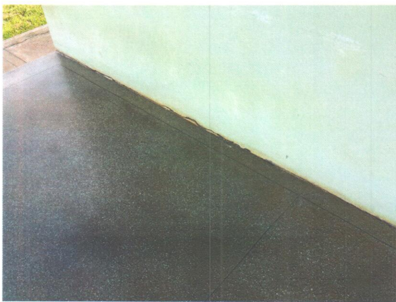
Fotografia 1 – Vista da circulação do bloco de salas na extremidade sul na união do piso da circulação com a parede. Detalhe para a fissuração deste.
