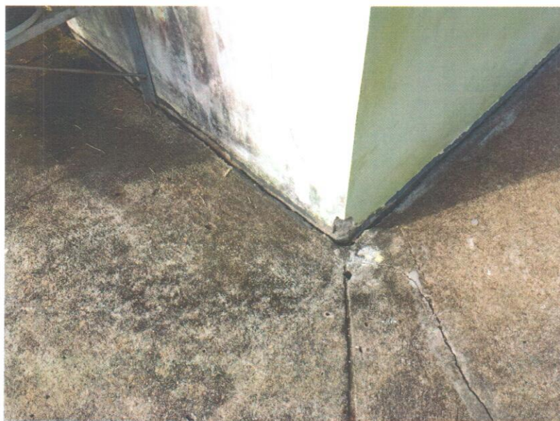
Fotografia 6 – Vista do canto sudoeste do bloco de salas com abertura significativa entre a parede do bloco e a calçada, podendo ocasionar problemas estruturais na edificação.
