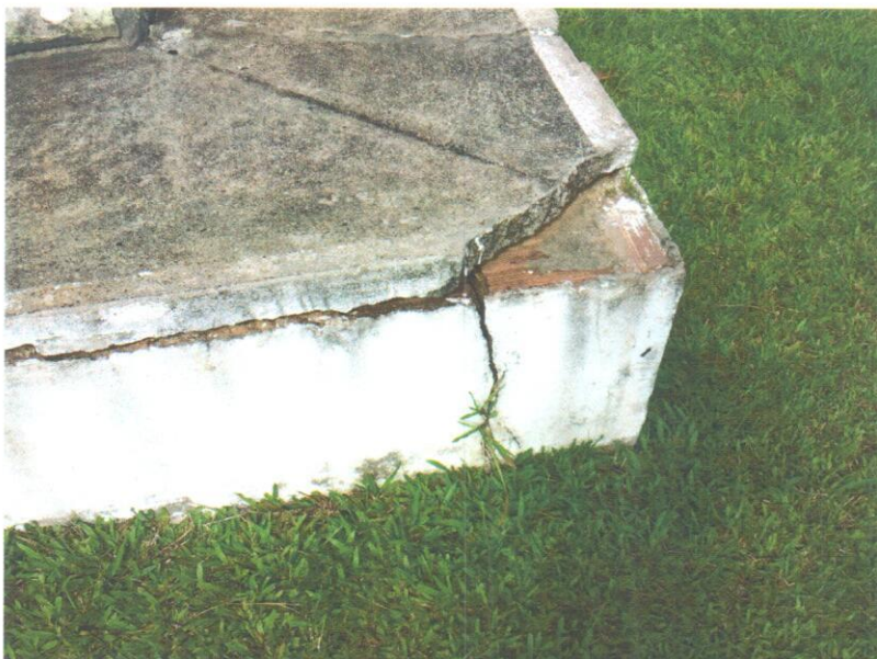
Fotografia 8 – Vista da borda da calçada no canto sudoeste da edificação. Mesmo com a aplicação de carga excessiva na borda da calçada, não deveria ter ocorrido a patologia apresentada.
