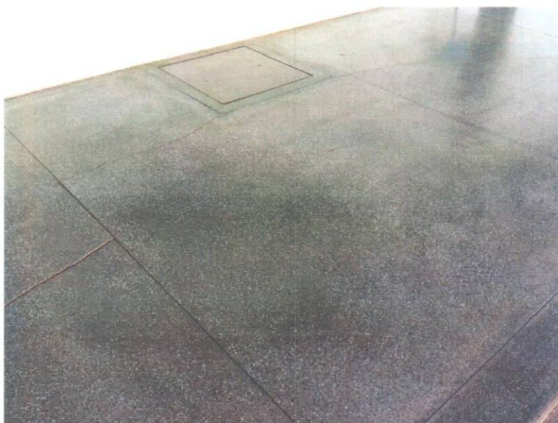
Fotografia 3 – Vista do piso do corredor do bloco de salas mostrado na Fotografia 2 , com detalhe para os trechos com fissura.
