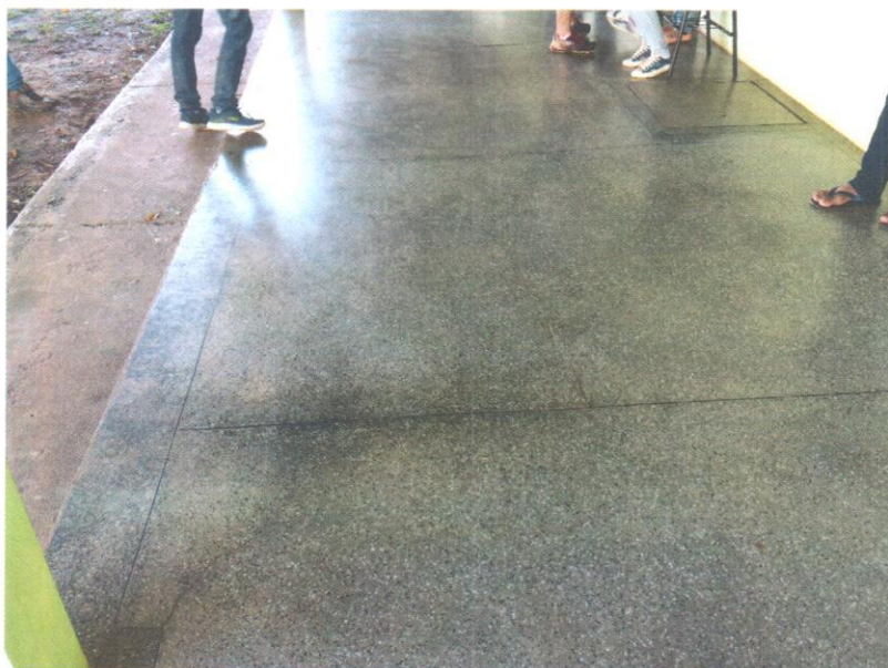
Fotografia 2 – Vista do piso da circulação detalhe para o processo de fissuração no piso.
