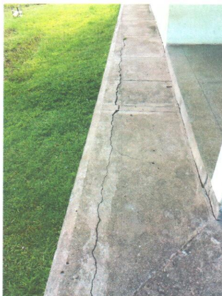
Fotografia 4 – Vista da calçada da fachada sul do bloco de salas de aula, detalhe para a fissuração da calçada entre a parede da edificação e a contenção da calçada.
