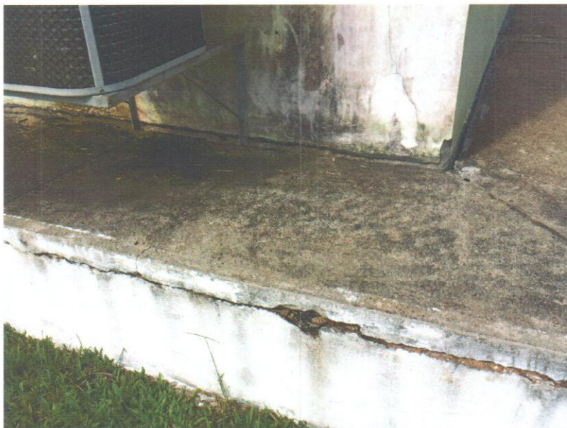
Fotografia 7 – Vista detalhada do canto sudoeste do bloco de salas de aula, detalhe do visível recalque sofrido pela calçada neste trecho da edificação, além da fissuração na borda externa da calçada.
