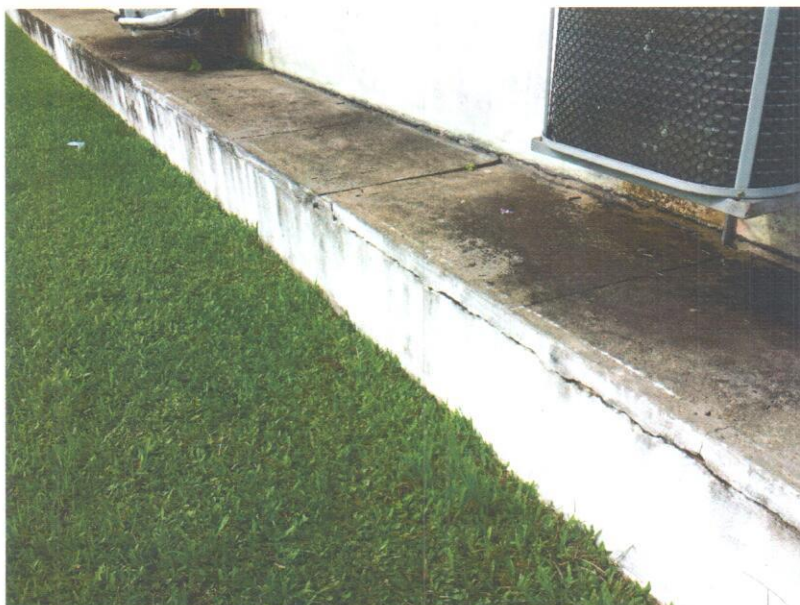
Fotografia 9 – Os problemas constatados na Fotografia 5, Fotografia 6 e Fotografia 7 ocorrem ao longo de grande parte da a calçada oeste do bloco de salas de aula do IFAM Campus Lábrea.
