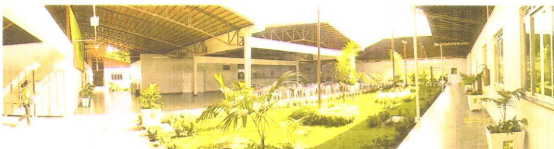
Fotografia 2 - Vista interna do IFAM Campus Parintins, detalhe para as estruturas metálicas de cobertura
