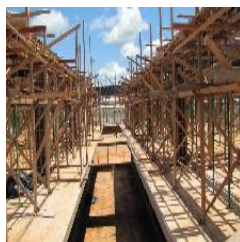
Vista da ala leste do pavimento superior do Bloco A. Destaque para as escoras das lajes de cobertura das salas de aula da ala esquerda e direita e para o rasgo da laje de piso.
