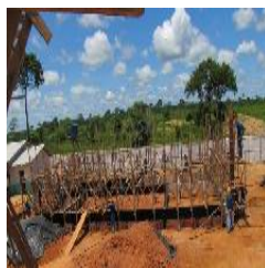
Vista panorâmica da Agroindústria. Nota-se o aterro e a compactação das caixas do embasamento.
