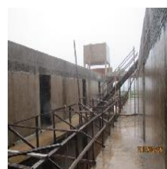
Vista interna do primeiro pavimento do corredor central ala direita do bloco A
