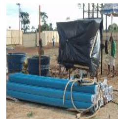
Vista interna do canteiro de obras, a partir do setor leste do terreno. No primeiro plano, destaque para a tubulação geomecânica a ser utilizados no poço, ao fundo portão de entrada da obra.
